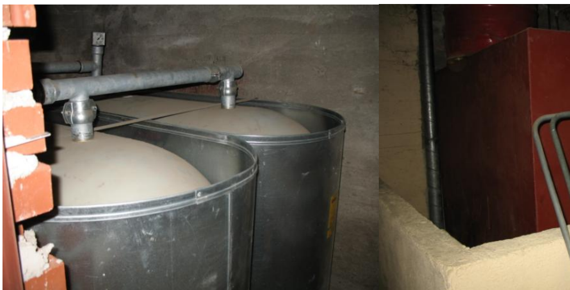
Kuva 3. Muoviset sisäsäiliöt teräksisessä suoja-altaassa säiliöhuoneessa ja teräksinen sisäsäiliö betonisessa suoja-altaassa.
